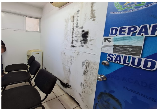
Foto 86. Departamento de Salud Pública con daño por humedad, mayo 2025.
